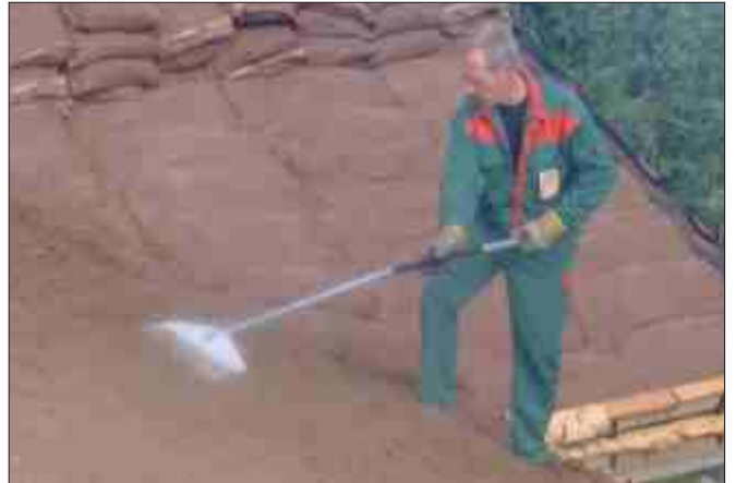
Zum Schluss wird eine dünne Torfschicht über das Dach verteilt und dann bewässert.
